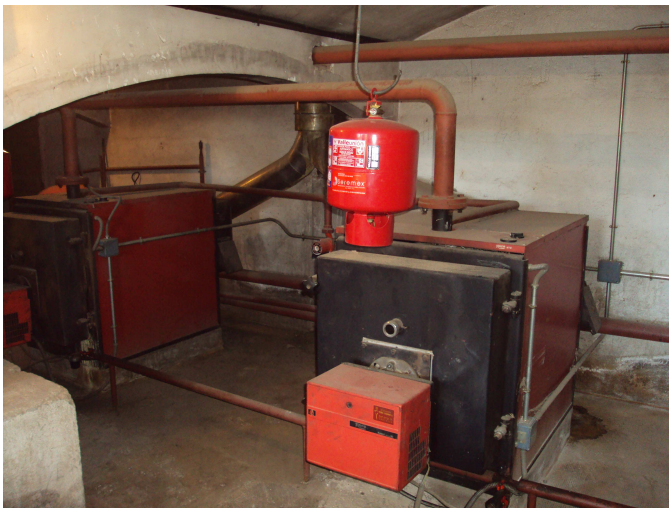
Fotografia interior de la sala de calderes (2 calderes de gasoil de 200 kW).
