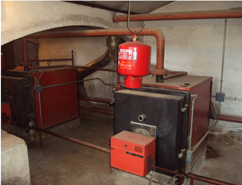
foto de les dues calderes de gasoil de 200 kW actuals
