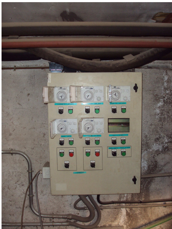
foto del quadre de control i comandament actual amb centraletes Siemens.
