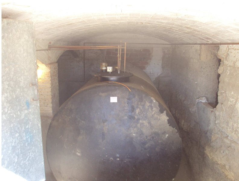
foto del dipòsit de gasoil de 10.000 l (interior-aeri)
