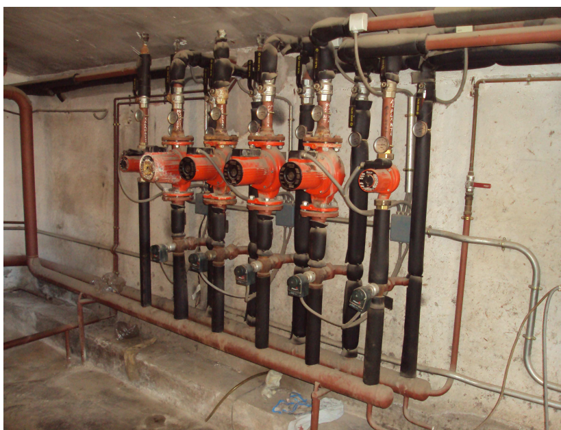
foto del col·lector de bombes actual
