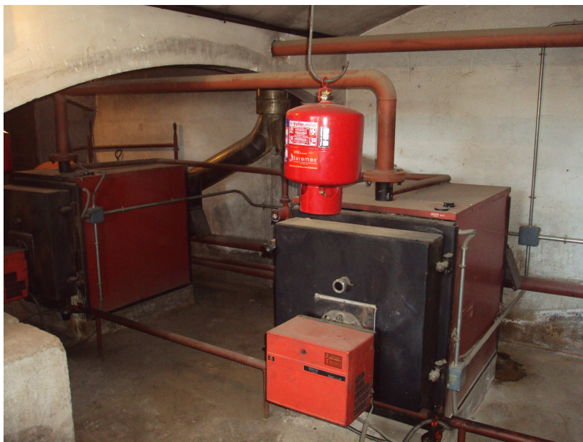
foto de les dues calderes de gasoil de 200 kW actuals
