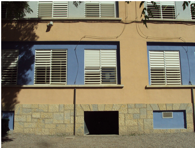
Fotografia d'accés a la sala de calderes pel pati de l'escola.
